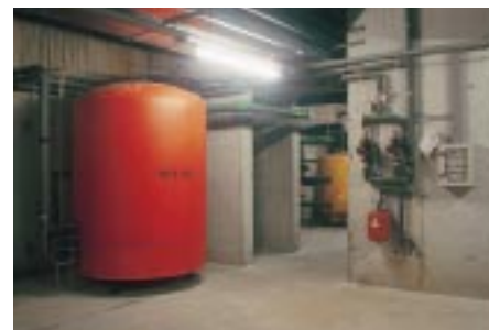
Dipòsit d'emmagatzematge solar tèrmic de 5.000 l., del circuit secundari.
